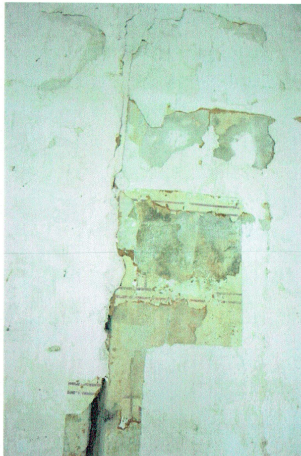
Vue rapprochée du décor peint de faux appareillage et de l'ouverture Noter l'état lacunaire du décor sur cette partie de l'édifice.
